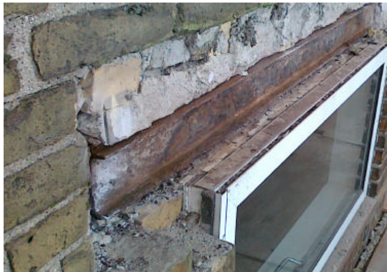
Rusten ståloverligger over trappevindue
