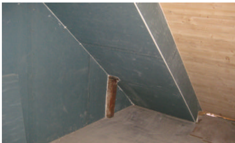
Tagflade set indefra ved brandkammerstatning.
